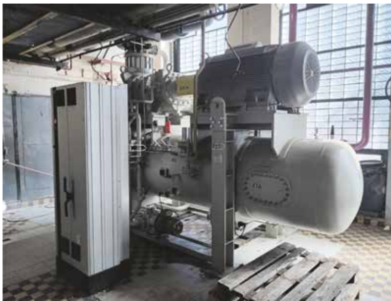
Obr. č. 7: Strojovna chlazení, pohled na jeden ze tří šroubových kompresorů.
