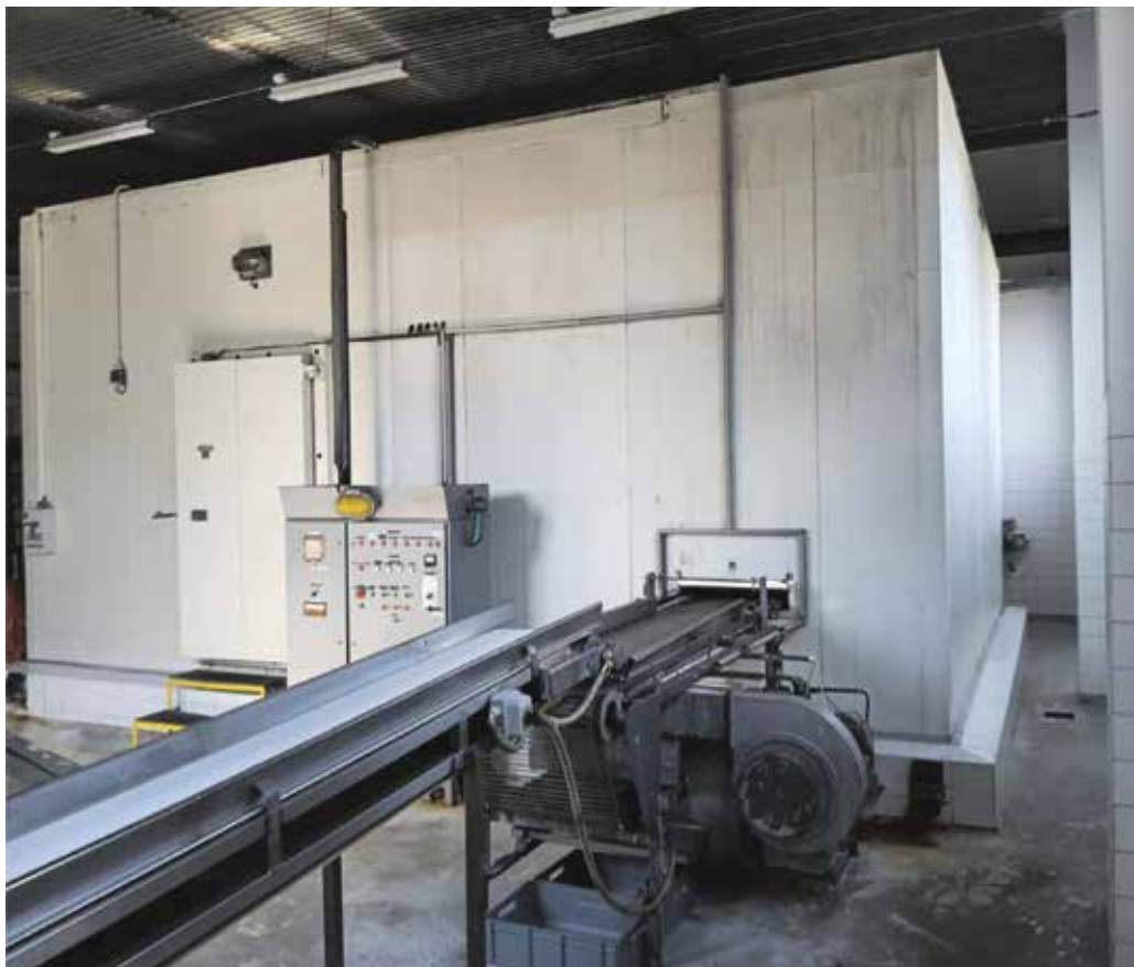
Obr. č. 2: pohled na vstup do zmrazovače
