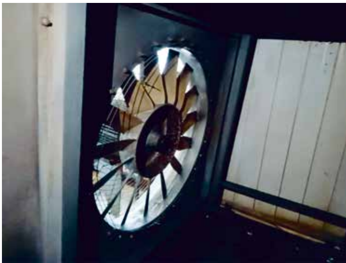
Obr. č. 4: pohled na oběžné kolo z prostoru pod chladičem vzduchu.
