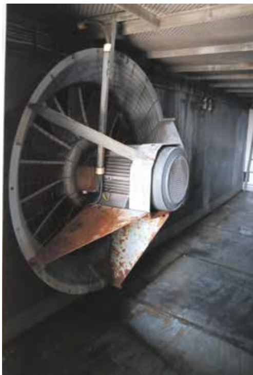
Obr. č. 3: pohled na ventilátor (průměr oběžného kola cca 1200 mm) a prostor s chladičem vzduchu
